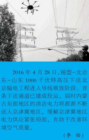
2016年4月28日,锡盟-北京东-山东1000千伏特高压下送北京输电工程入京导线展放阶段,首条下送通道已建成投运,届时内蒙古东部地区的清洁电力将源源不断送入京津冀地区,缓解京津冀地区电力供应紧张局面,有助于改善环境空气质量。
