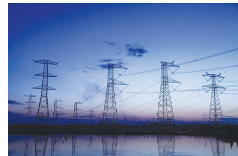
特高压输电线路在正常运行情况下,允许导线发生一定程度的电晕放电。
